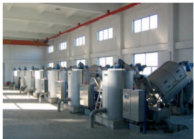
Flera enheter installerade parallellt för att ta hand om 600 m 3 /h
