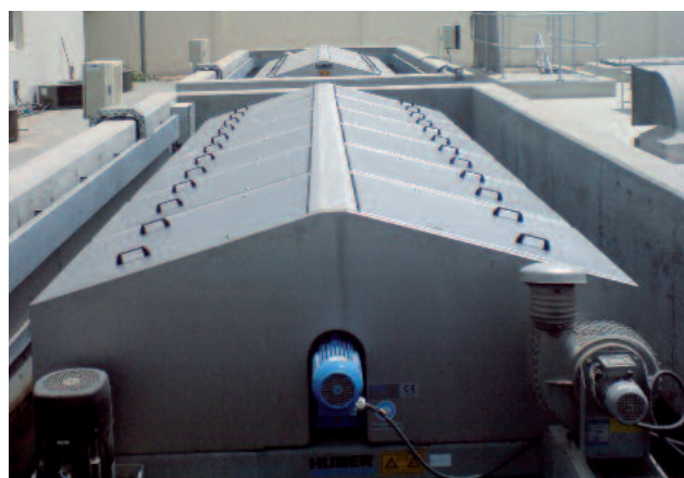
RoDisc® med 20 skivfilter installerade i en betongtank
