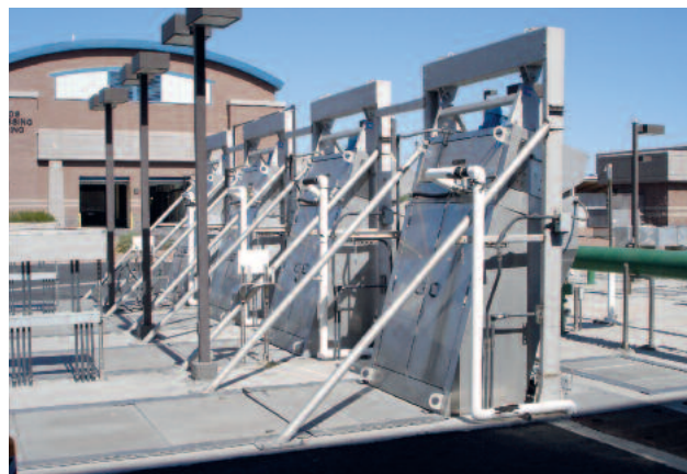
4 установки HUBER STEP SCREEN® SSV: L= 5300, W=1376, ширина прозора 6 мм, угол установки 75°. Максимальная устойчивая работа благодаря специальной конструкции нижней ступени, которая повышает надежность работы, исключая повреждение песком, гравием и камнями.
