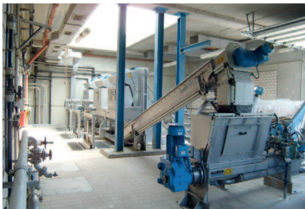
3 установки HUBER STEP SCREEN® SSV: L=4300, W= 1176, ширина прозора 3 мм. Оптимальная регулировка с учетом особых конструкторских условий (большие высоты сброса, глубокие каналы) благодаря установочному углу наклона от 70° до 80°.
