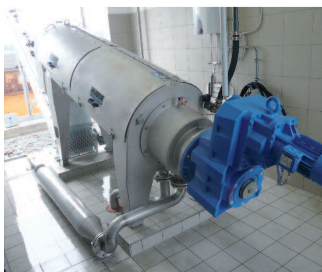
Instalação com uma capacidade de sólidos de 300 lbs (libras) por hora
