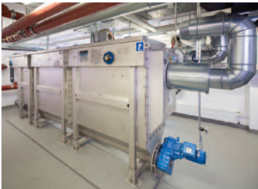
HUBER Heat Exchanger RoWin at Klinikum rechts der Isar
