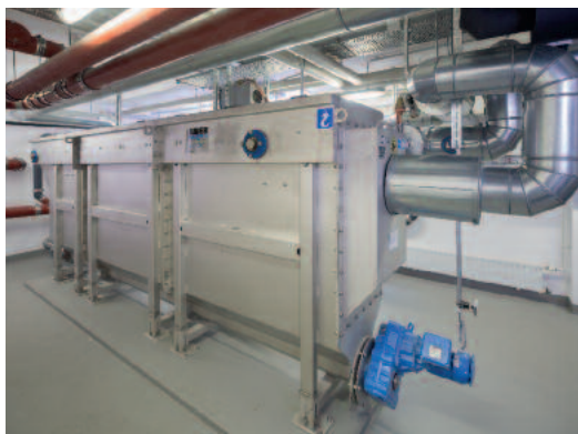
HUBER Abwasserwärmetauscher RoWin im Klinikum rechts der Isar
