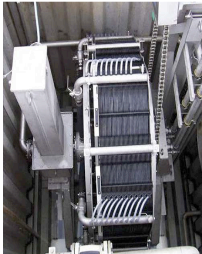
VRM Pilotanlage Membranbiologie mit Filtrationskammer
