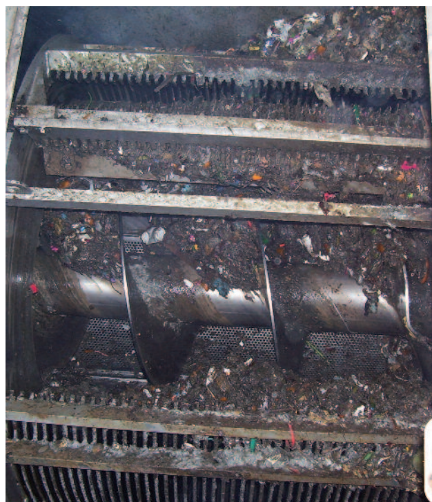
In der Feinstrechenanlage werden die nicht aufgelösten Feststoffanteile aus der Organiksuspension entfernt (ca. 5 - 15 % des Zulaufs)
