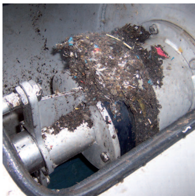
Austrag der entwässerten Störstoffe aus dem Fremdstoffabscheider
