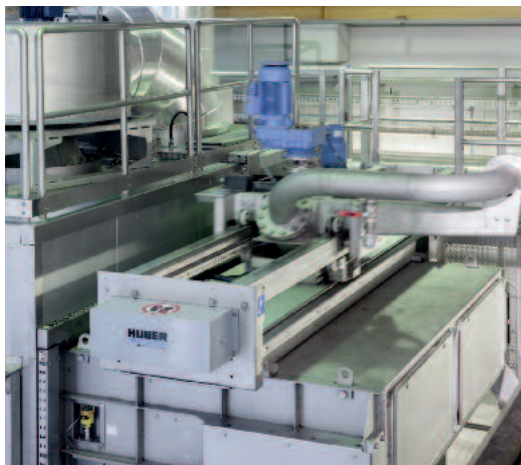
HUBER Extruder zur Aufgabe des entwässerten Klärschlammes.
