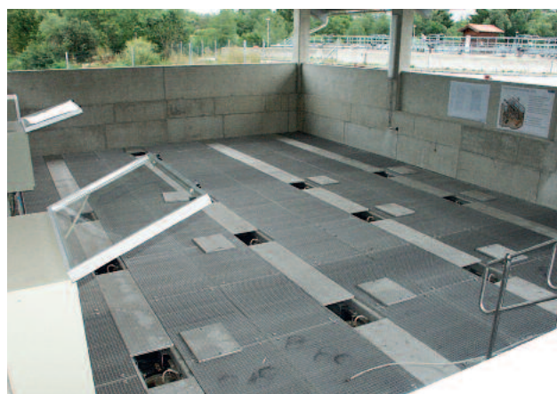
HUBER Sandfilter CONTIFLOW® 50 C , Wolfratshausen, Deutschland
