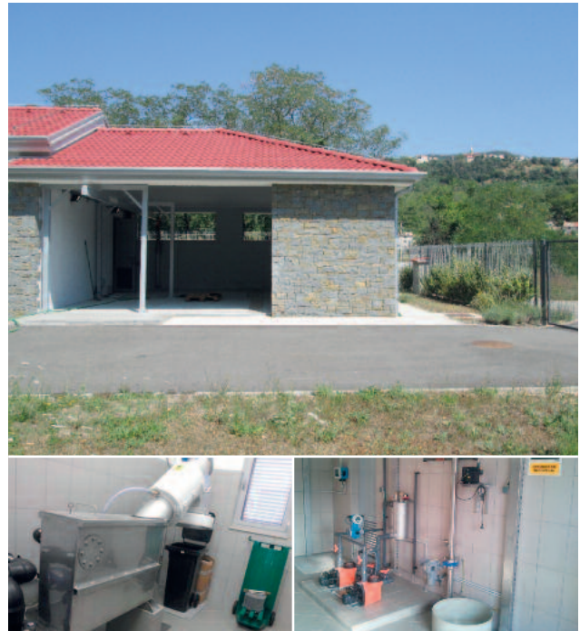
HUBER BioMem® Kompaktkläranlage in Roc, Kroatien
