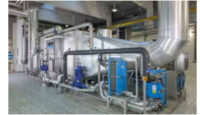
Kondensationsstufe mit Wärmeauskoppelung und vollautomatischer Wärmetauschreinigung.
