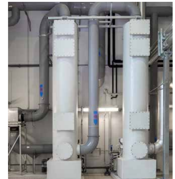
Zweistufiger Wäscher zur Abluftbehandlung.
