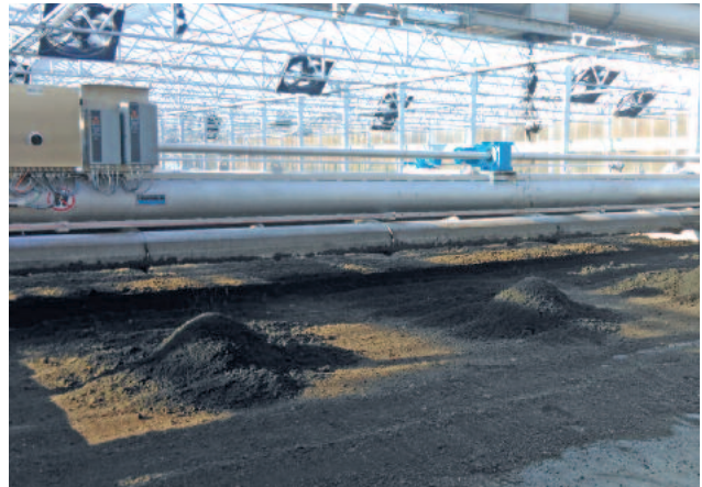
Schlamm wird automatisch über Schnecken eingebracht.
