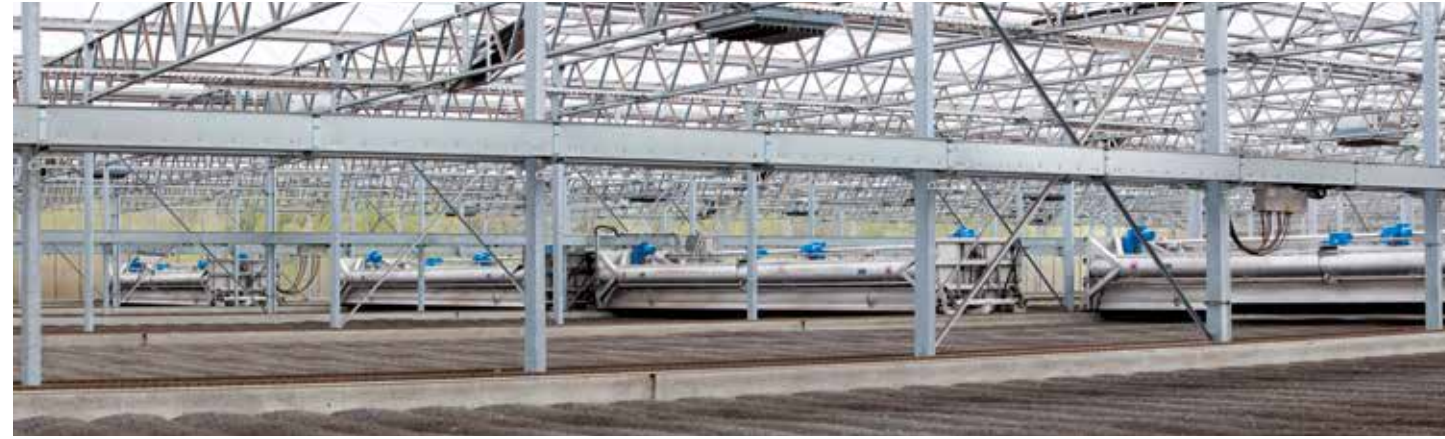
Parallelbetrieb HUBER Schlammwender SOLSTICE®.
