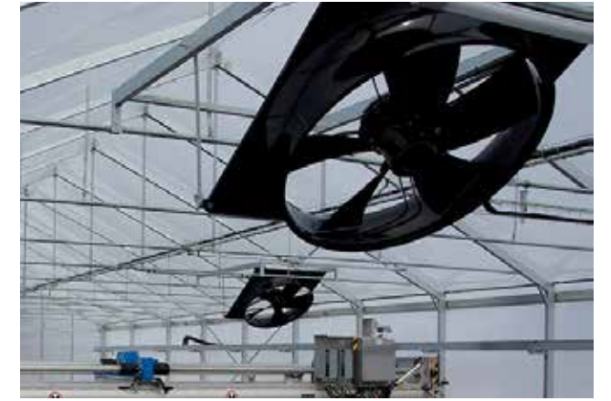
Umluftventilatoren sorgen für verbesserte Verdunstung.
