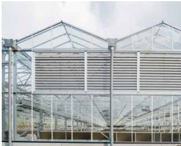
Über Wetterschutzgitter gelangt Frischluft in die Trocknungshalle.
