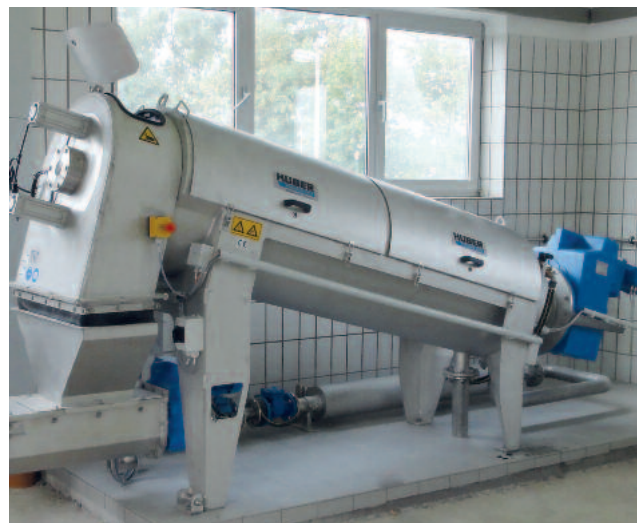
Fest installierte Presse für 140 kg TR /h
