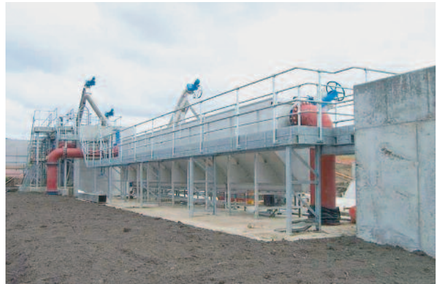
Oberirdischer HUBER Langsandfang ROTAMAT® Ro6 mit vorgeschalteter Siebung
