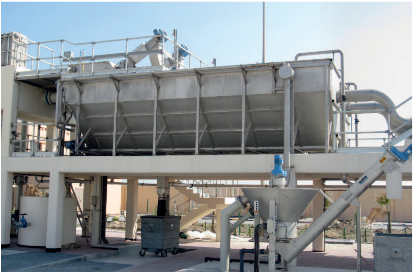
HUBER Kompaktanlage ROTAMAT® Ro5 mit nachgeschaltetem HUBER Coanda Sandwaschanlage RoSF 4
