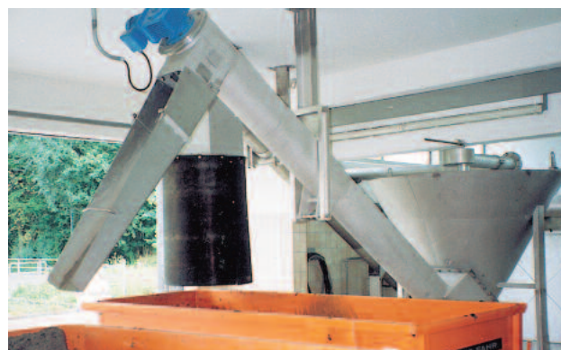
Eine Klassierschnecke transportiert das abgeschiedene Sandfangmaterial aus dem Abscheideraum in den Container.
