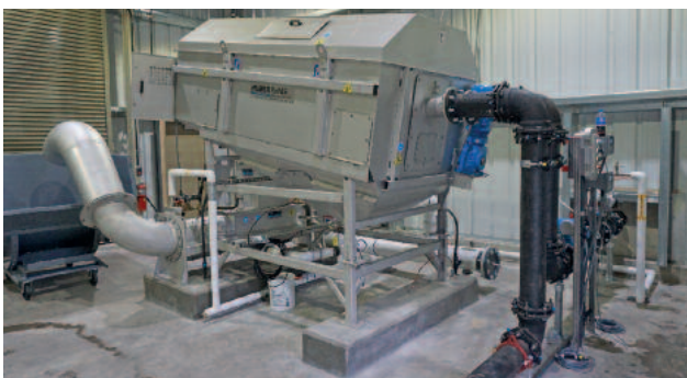
ROTAMAT Fäkalannahmestation im Einsatz
