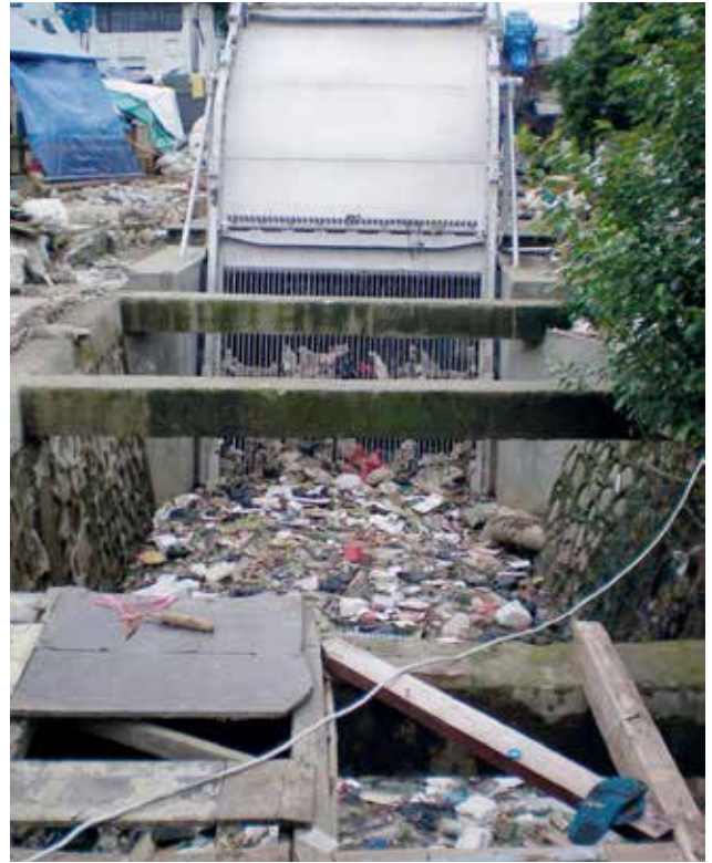
In Betrieb befindlicher HUBER Grobrechen TrashMax®.
