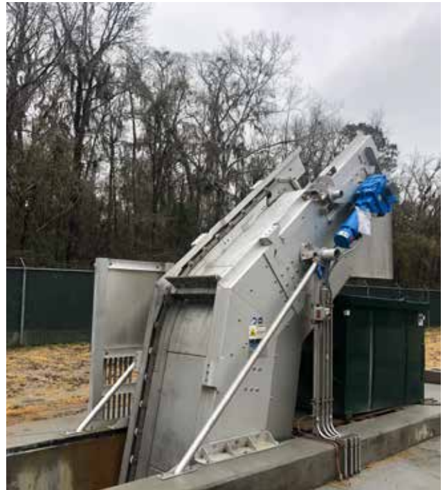
Recheninstallation im Zulauf einer Pumpstation mit Abwurf direkt in einen Container.
