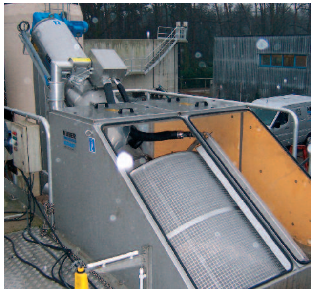
Installation im Freien mit Abdeckung und wärmegeämmter Spritzwasserleitung
