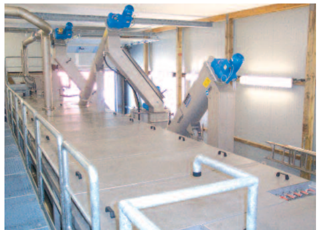
Sauberer Rechengut- und Sandfanggutaustrag bei der HUBER Kompaktanlage ROTAMAT® Ro5
