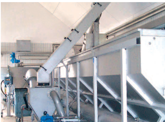
Rechengutintensivwäsche WAP® SL nach einer HUBER Kompaktanlage ROTAMAT® Ro5
