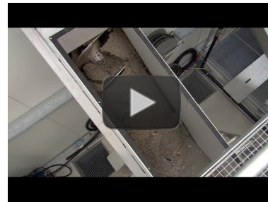
Video: HUBER Coanda Sandwaschanlage RoSF4, eingesetzt im HUBER Sandaufbereitungsverfahren RoSF 5 https://www.youtube.com/watch?v=QM5e-dyKnRo
