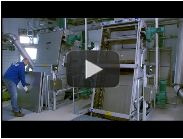
Video: HUBER Coanda Sandwaschanlage RoSF4 auf einer kommunalen Kläranlage https://www.youtube.com/watch?v=CDlin9M5Mes
