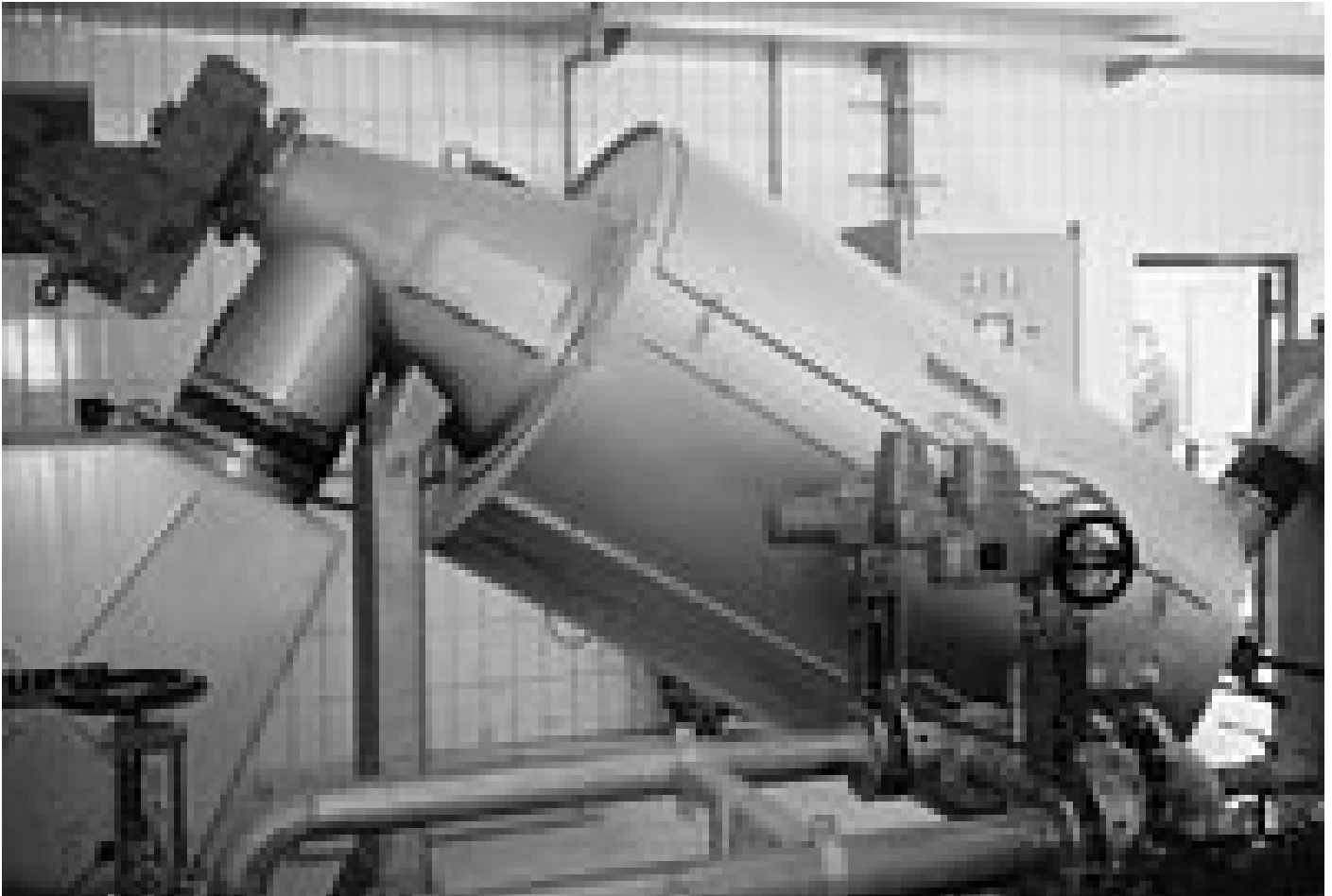
Die neue maschinelle Überschussschlammeindickung komplett installiert auf der Kläranlage St. Micheal/Lungau in Österreich
