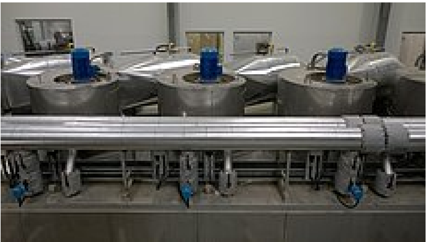
Warmwasserversorgung und Ventilatoren des Trockners mit Isolierung in V4A
