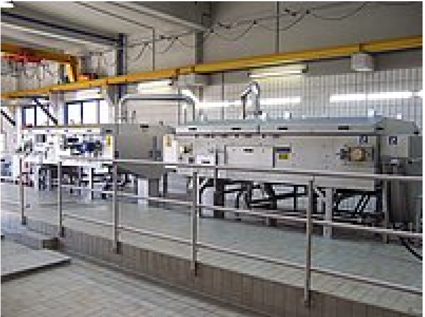
Zwei HUBER Drainbelt DB 2 mit Abdeckungen und automatischer Bandreinigung
