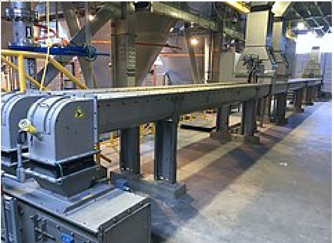
HUBER-Fördertechnik für den Schlammtransport
