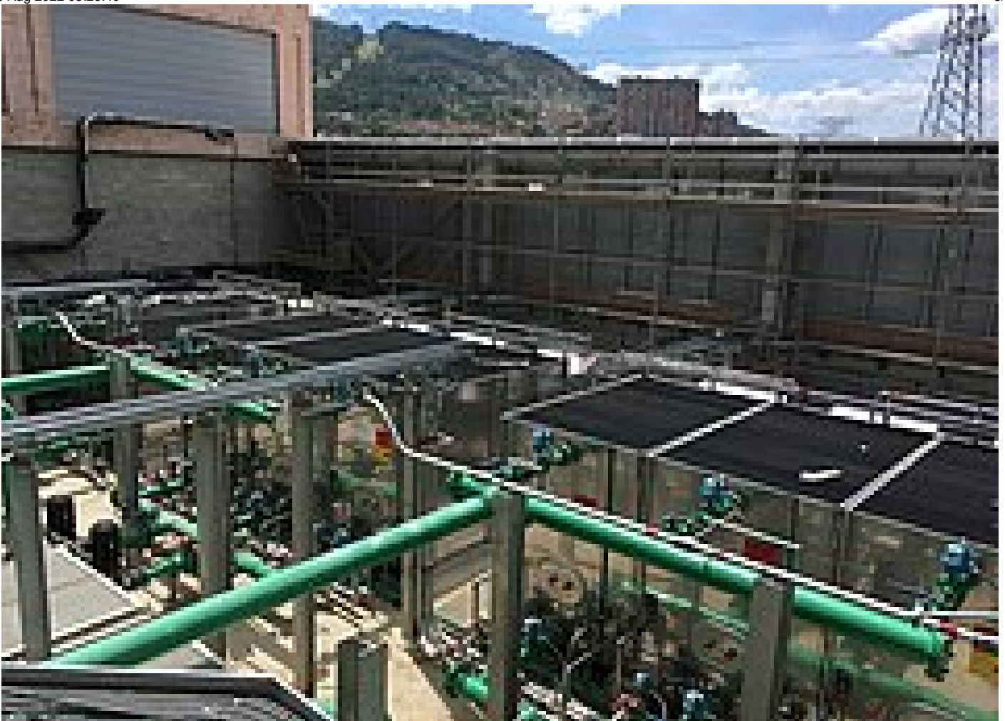
Kühltürme und Abluftbehandlung
