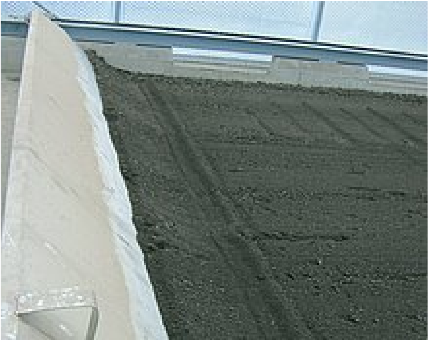
An der „Halfpipe“ liegt der trockene Schlamm der entweder aus dem System genommen wird oder zum Rückmischen verwendet werden kann.
