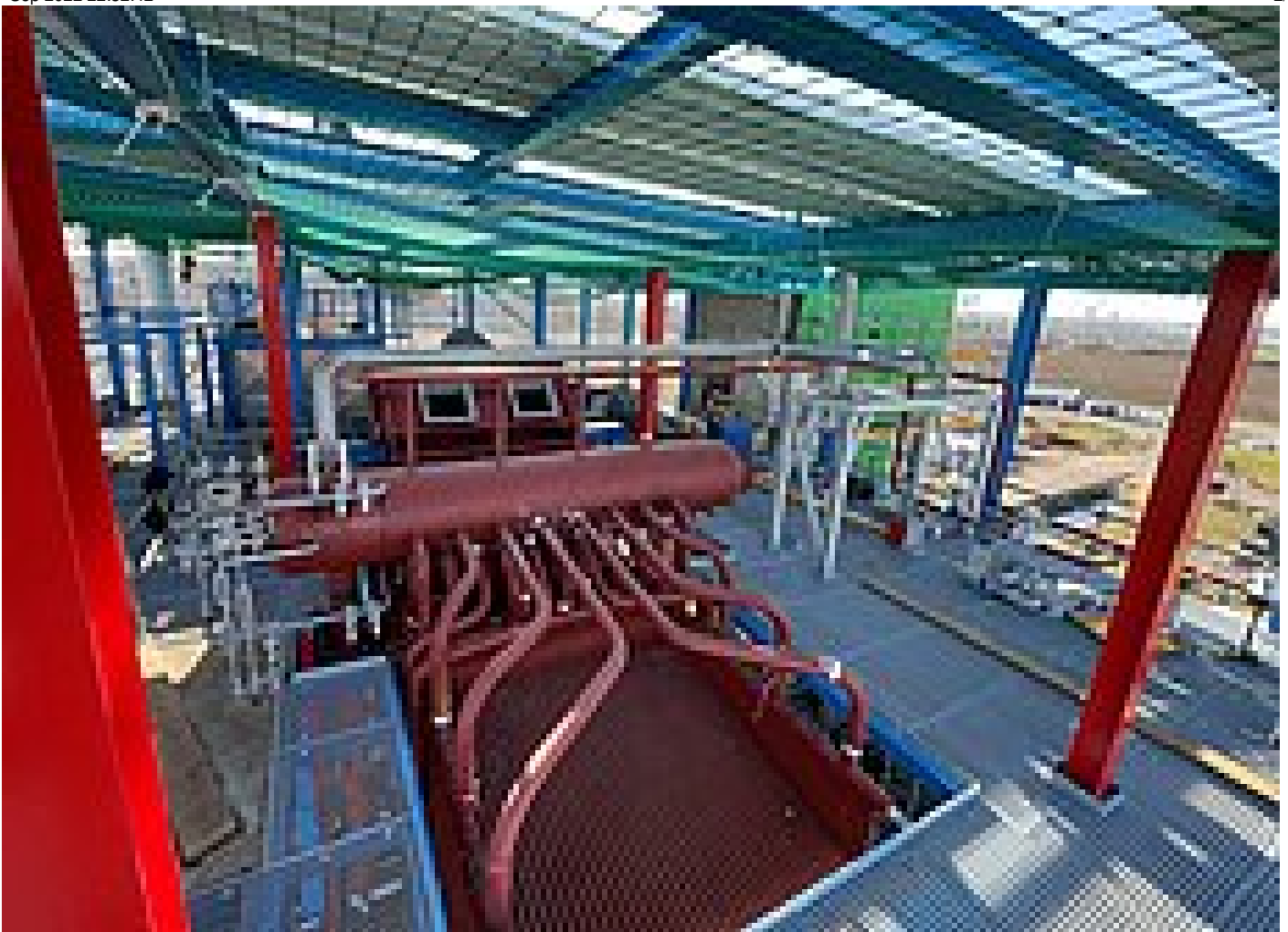
Dampftrommel der Klärschlammverbrennungsanlage
