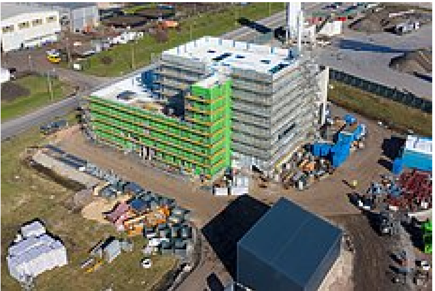
Ansicht der Klärschlammverbrennung von oben
