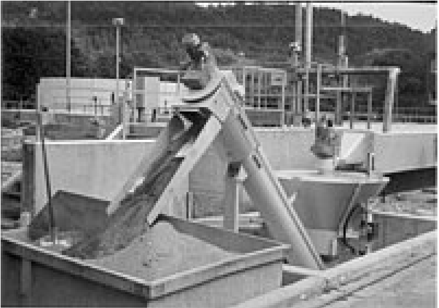
Coanda-Sandwaschanlage, Typ: RoSF 4/BG II, auf der KA Blankenkoch, Glühverlust < 2 %
