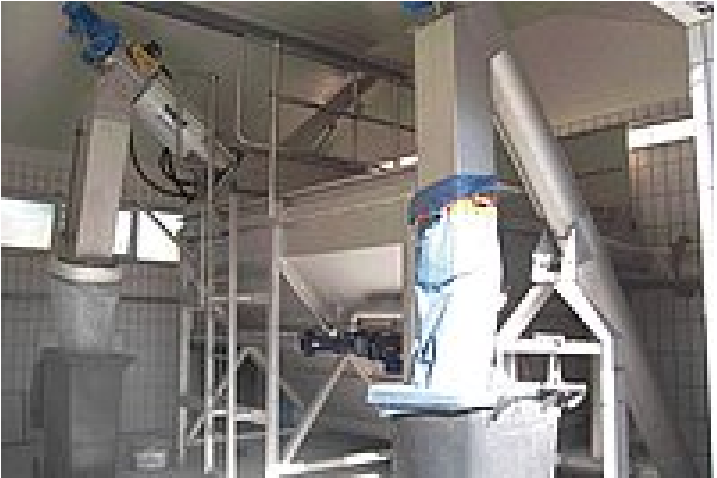
Klein – fein – effizient; die ROTAMAT® Kompaktanlage Ro5 HD in Wittislingen
