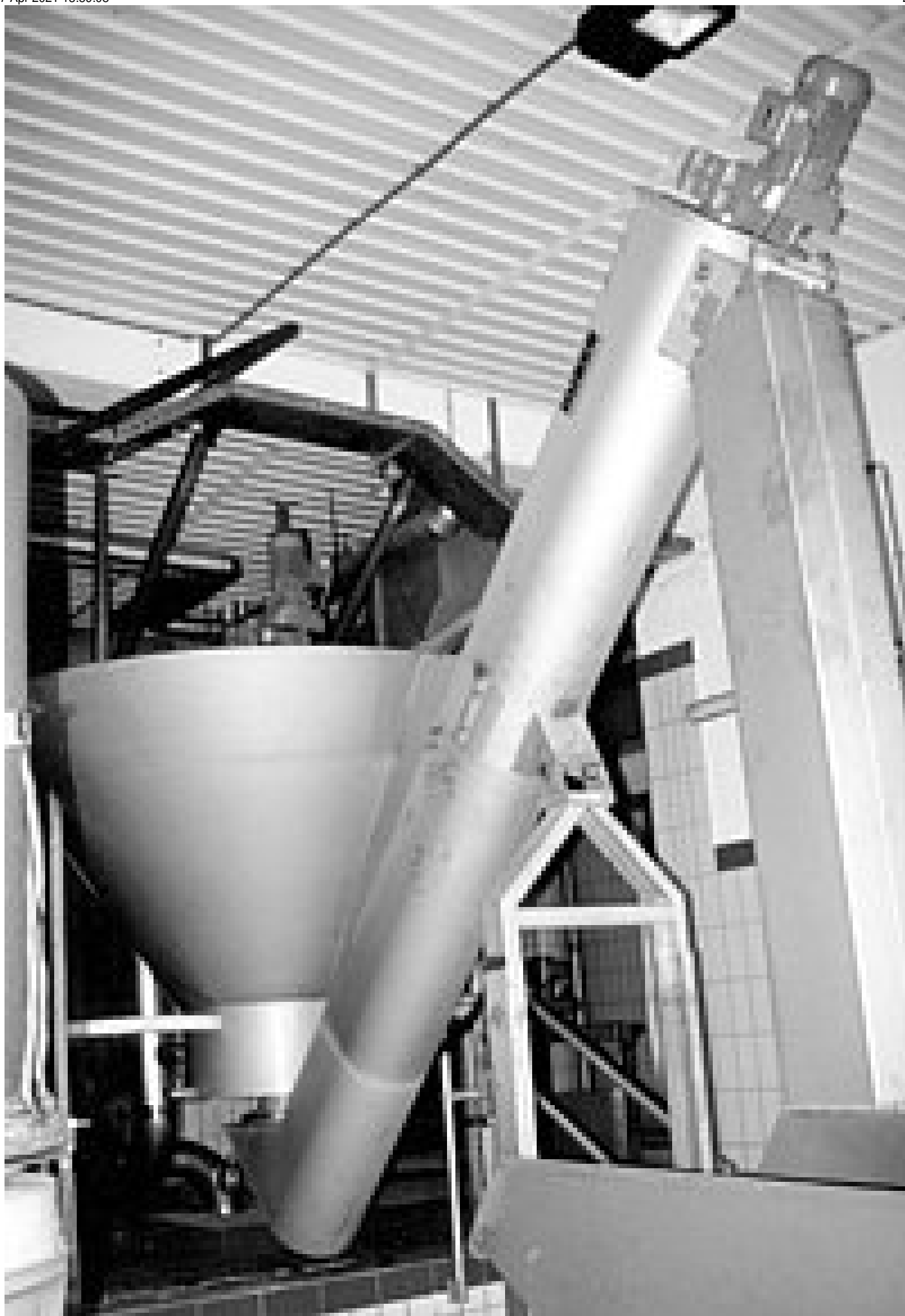
Huber Sandwaschanlage RoSF 4 Ansicht der Sandauffangsschnecke im Container
