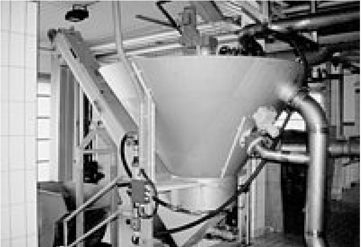
Huber Sandwaschanlage RoSF 4 Ansicht des Organikabzuges sowie der Ablaufleitung
