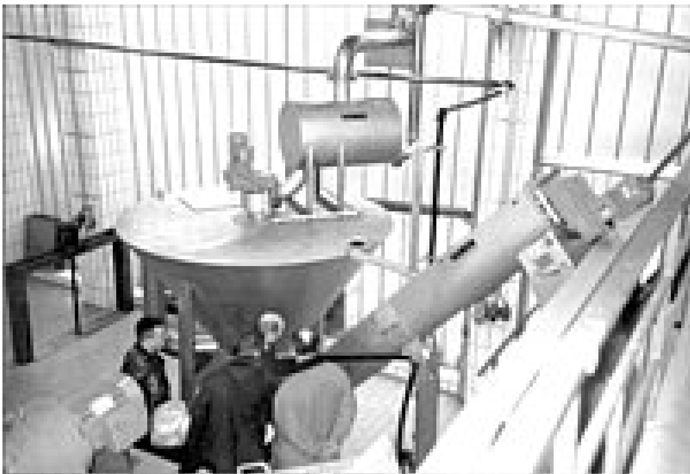
HUBER Sandwaschanlage RoSF4 im Rechengebäude fertig installiert
