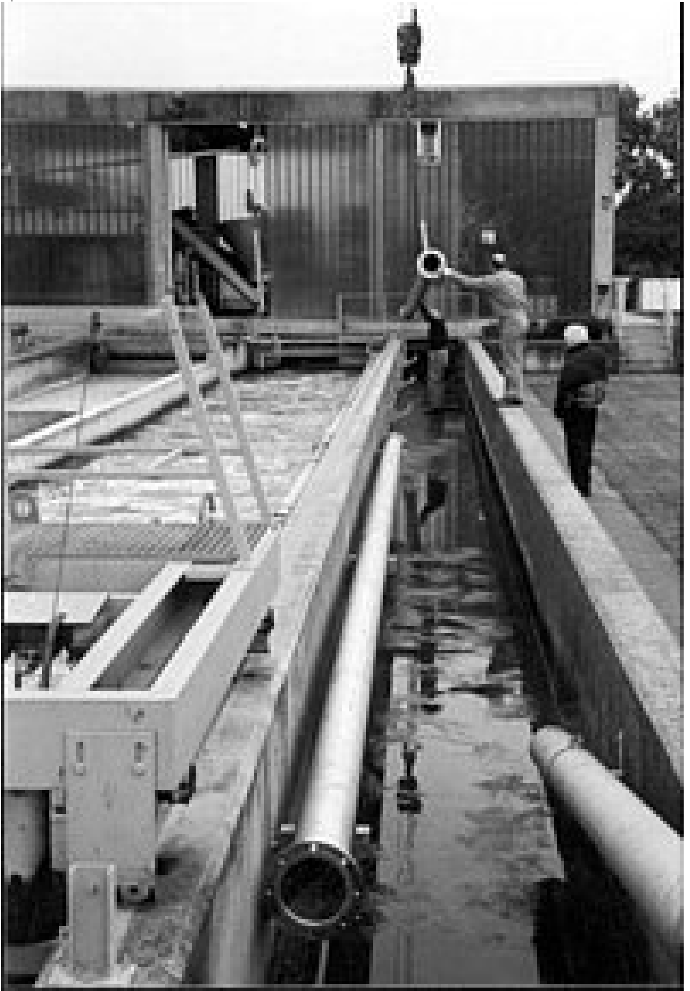
Betriebsbereite Rohrleitungen der RoSF4 Anlage
