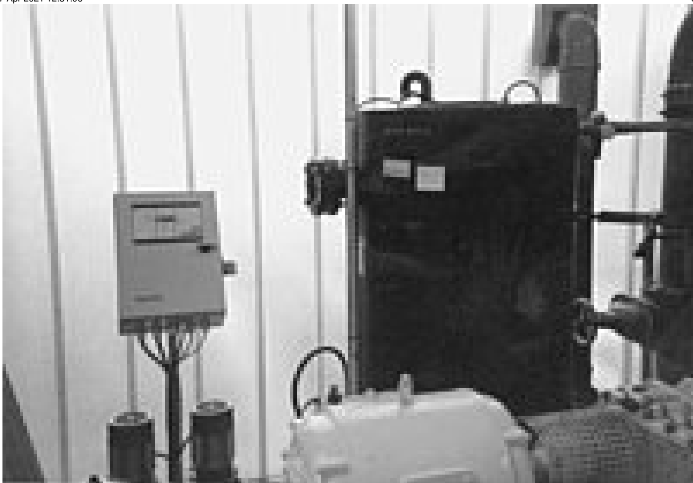
Brauchwasserversorgungsanlage mit Bedienpult
