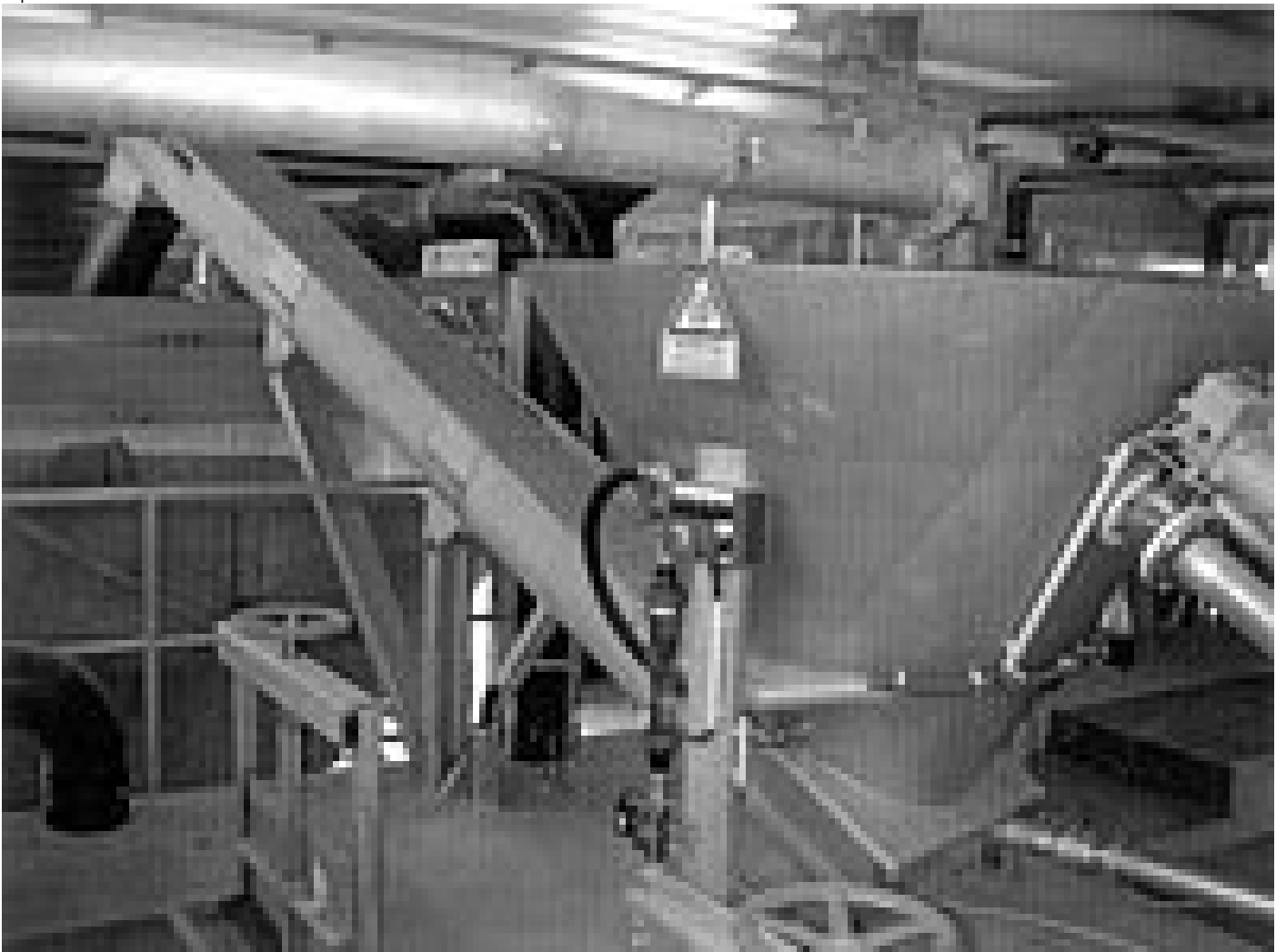
HUBER Sandwaschanlage, Kläranlage Herten-Westerholt
