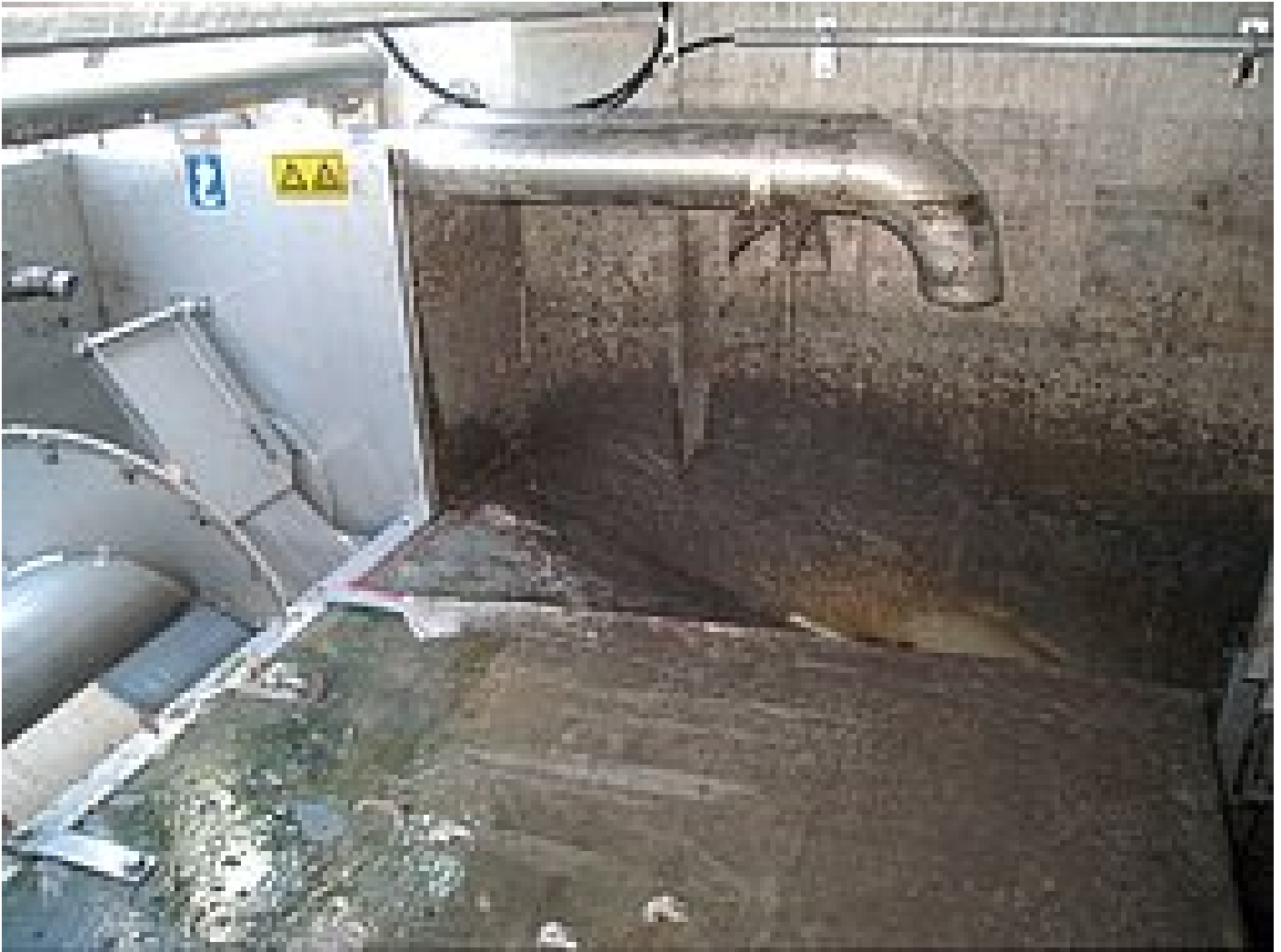
Bild 2: Siebgut-Schwemmrinne im Bermen-Beton, links Spülleitung, oben RÜB-Entleerleitung
