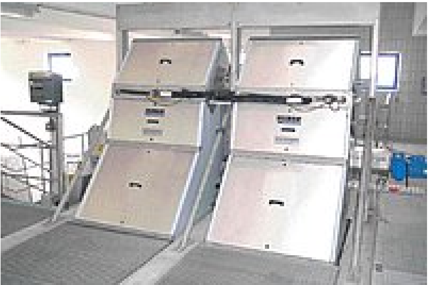
: Parallel geschaltete Ausführung des STEP SCREEN® Flexible – high efficiency SSF-he.
