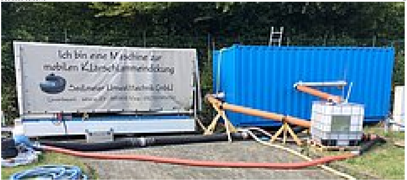
Bild 2: Überbrückungsbetrieb - Pumpenbeschickung der Vorführanlage HUBER Trommelsieb LIQUID (rechter Container) und Ablauf des gesiebten Abwassers im Freispiegel, Dünnschlammverdickung mit mobilem HUBER Scheibeneindicker S-DISC (im linken Container)
