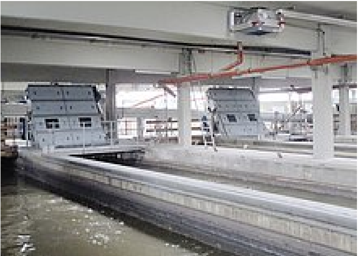
HUBER Harken-Umlaufrechen RakeMax® Hybrid mit Spaltweite 3 mm auf der Hauptkläranlage Wien im Auslaufbereich des Sandfanges
