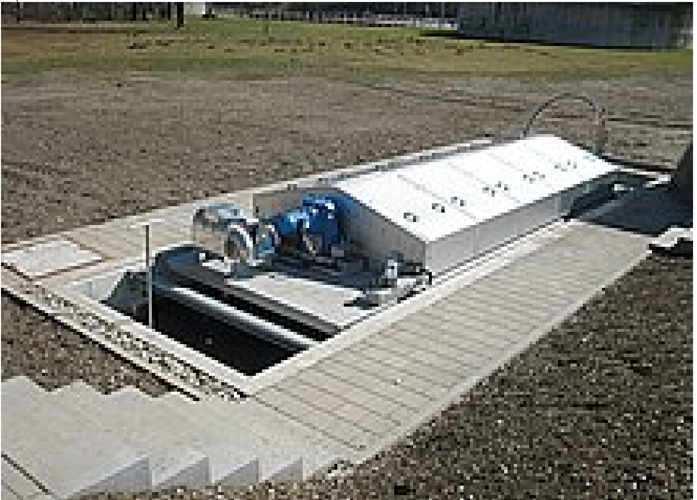
Installierter Scheibenfilter RoDisc® auf der Kläranlage Altötting.
