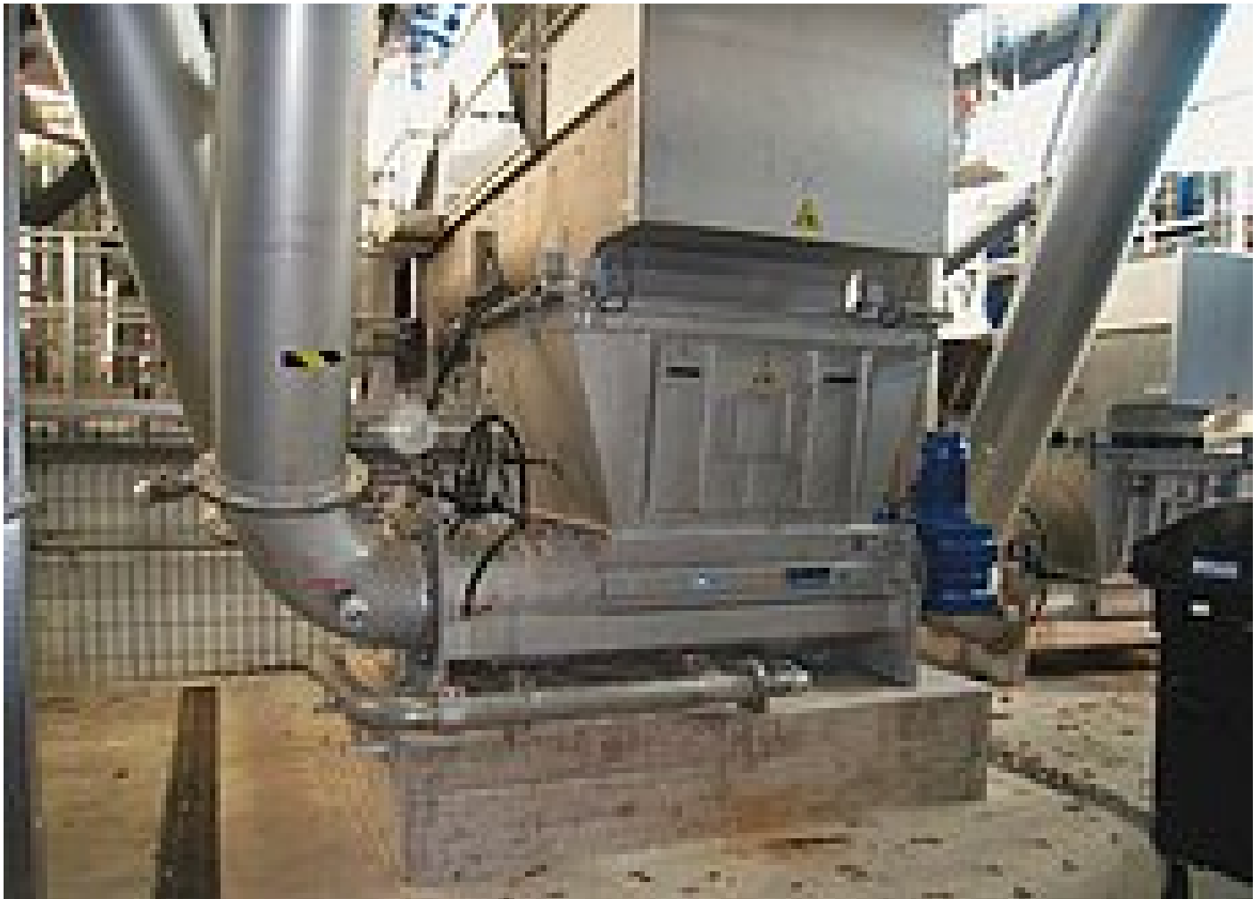
HUBER Waschpresse WAP 2x8 mit einer Durchsatzleistung von je 16m³/h
