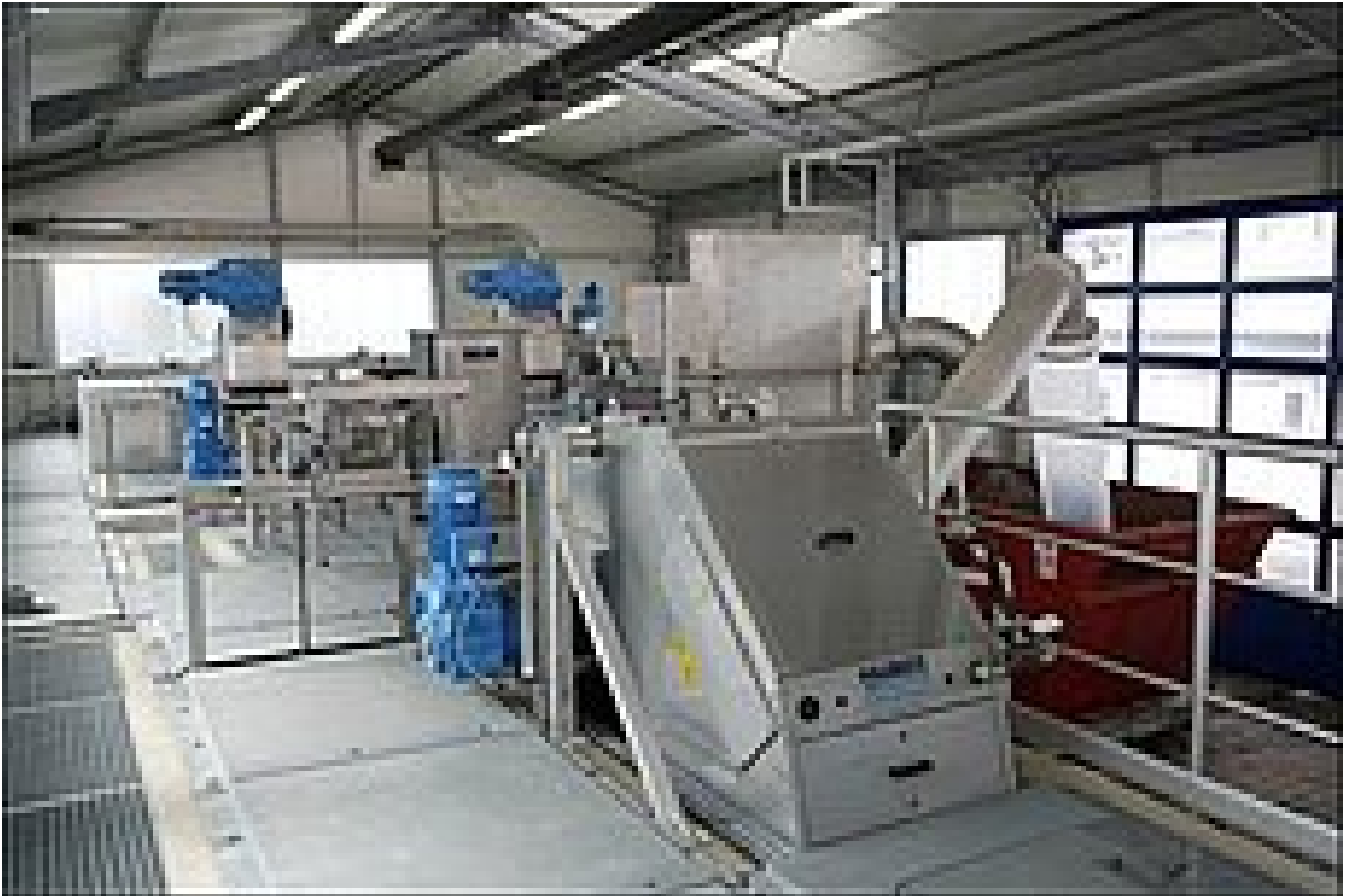
Grob- und Feinstsiebung auf der Kläranlage Glessen / Deutschland
