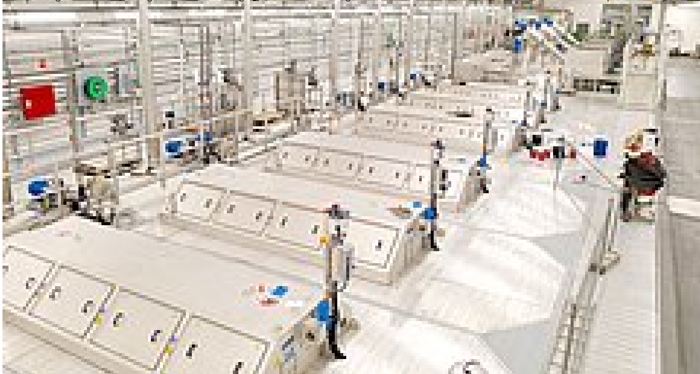
HUBER Komplettlösung installiert und betriebsbereit
