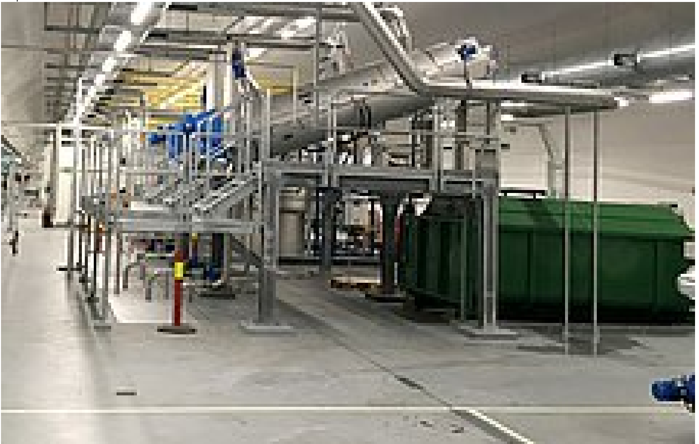
Die Schlammentwässerung erfolgt durch diese beiden HUBER Schneckenpressen S-PRESS
