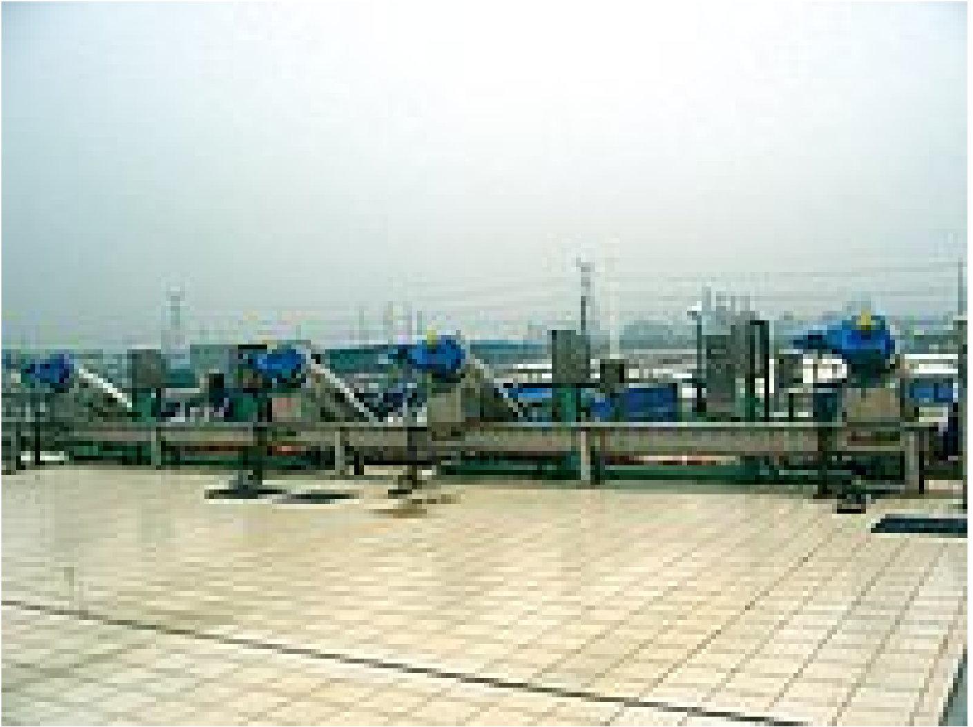
Vier ROTAMAT® Feinstrechen Ro 1/2200 eingebaut auf der KA Zhuyuan in Pudong, dem Wirtschaftszentrum von Shanghai.
