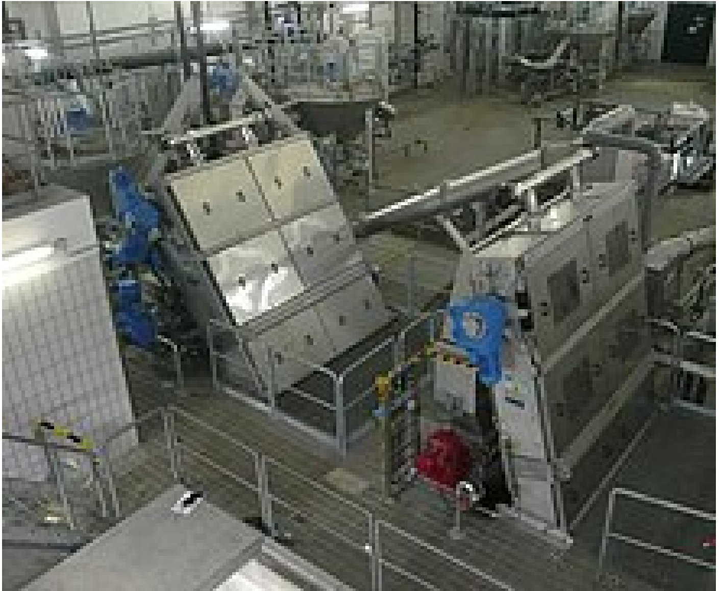
Linie 1 kurz nach der Inbetriebnahme
