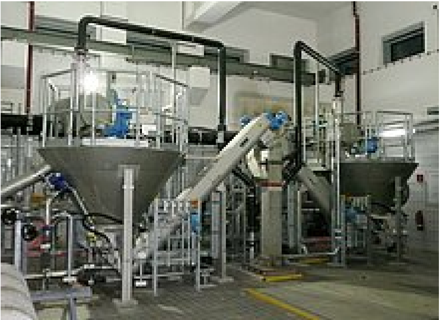
Bereits seit 2011 im Einsatz – HUBER COANDA-Sandwaschanlagen vom Typ RoSF 4 BG 16 l/s
