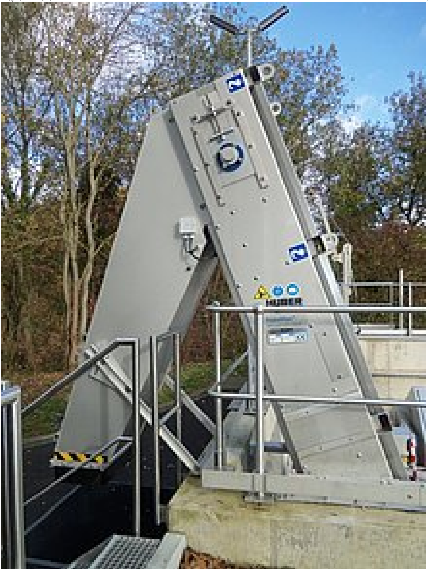
RakeMax®-J in der KA Aachen-Horbach, im Gerinne installiert
