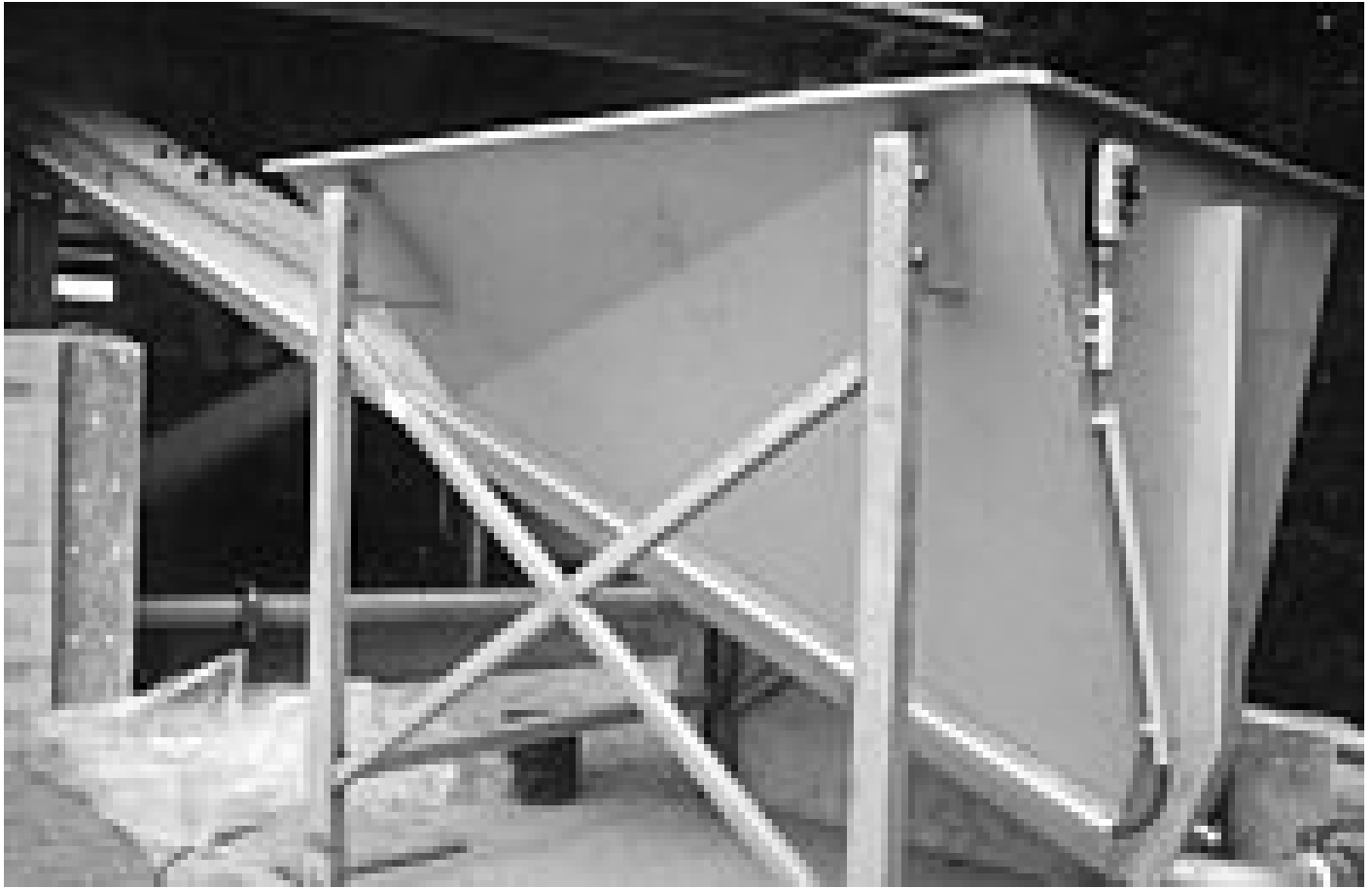
Kanalsandannahme auf der Kläranlage Pfattertal (Aufgabebereich)
