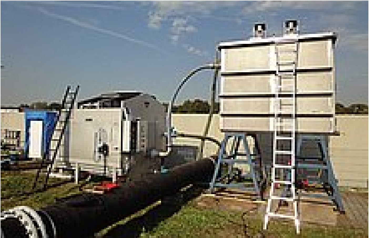
RoDisc® Scheibenfilter-Versuchsanlage mit vorge- schaltetem Flockungsreaktor auf dem Klärwerk Mannheim
