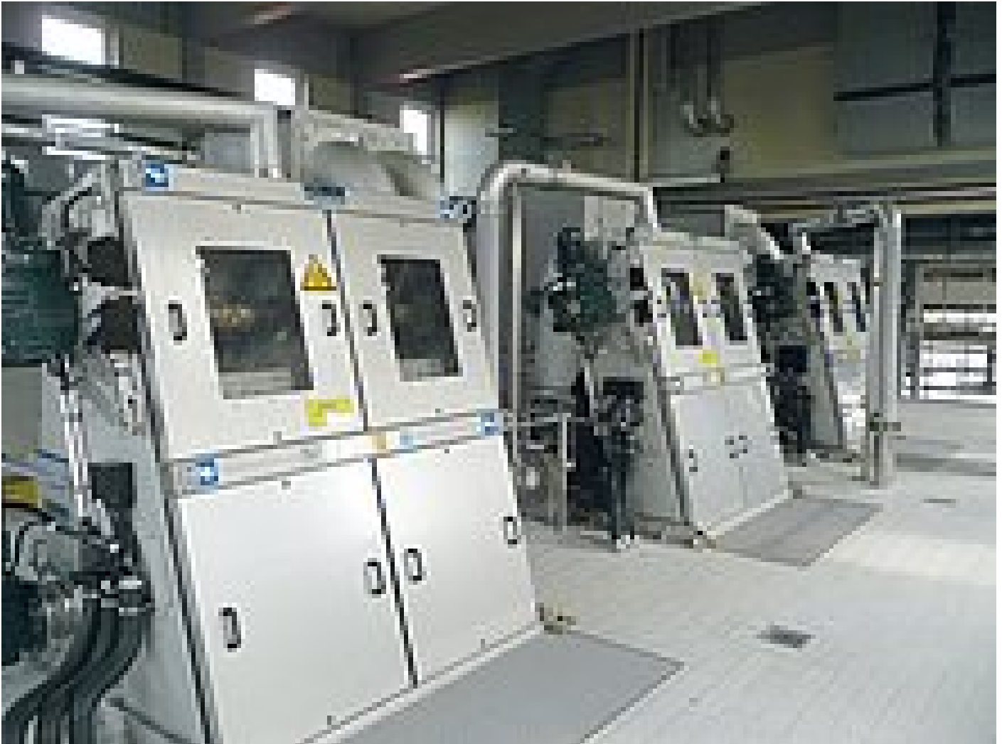
Drei Harken-Umlaufrechen RakeMax® auf dem Klärwerk Magdeburg / Gerwisch
