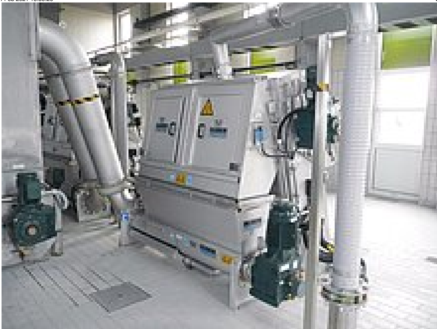
Abwurfseite des Grobrechens mit Waschpresse
