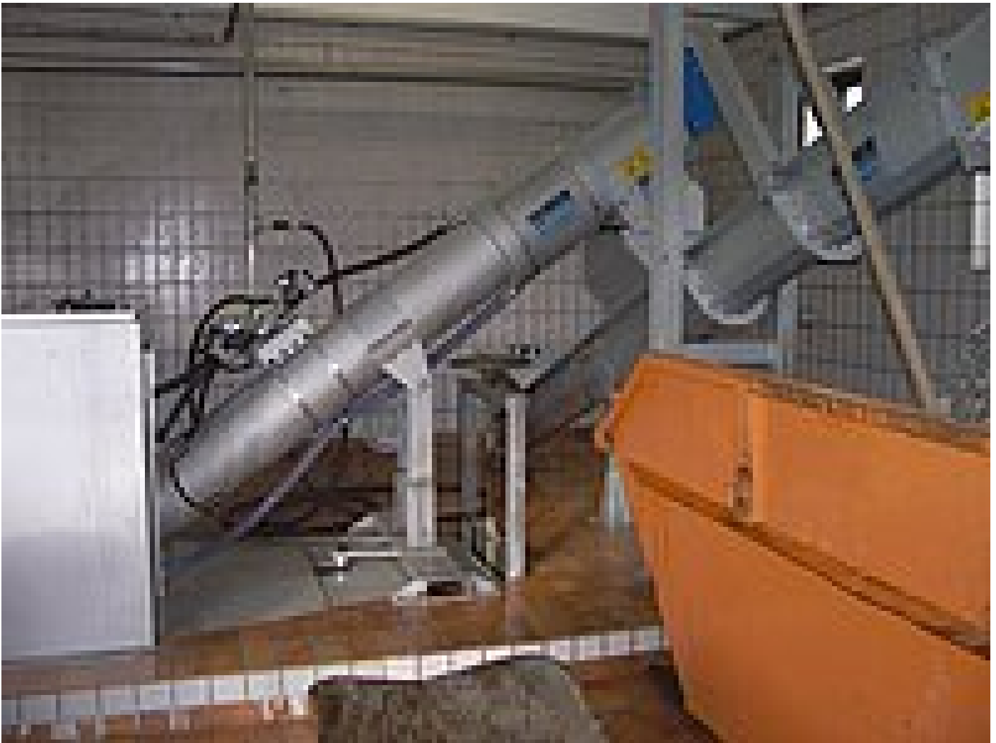
Frontansicht der installierten HUBER Maschinen in Garmisch
