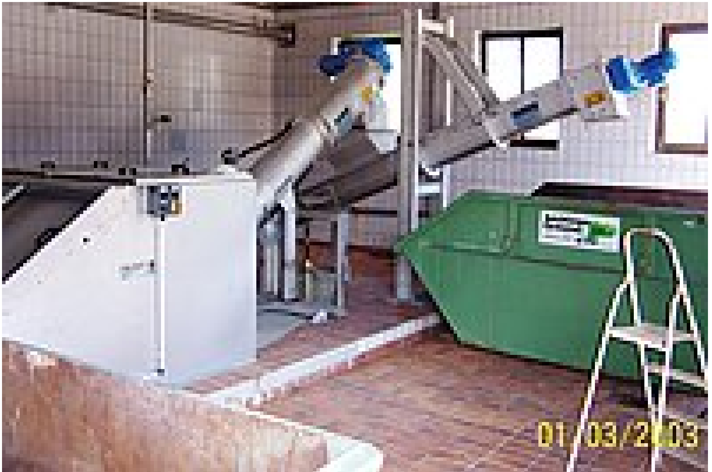
Die installierten HUBER Maschinen mit Siebgutabwurf im Container auf der Kläranlage Garmisch
