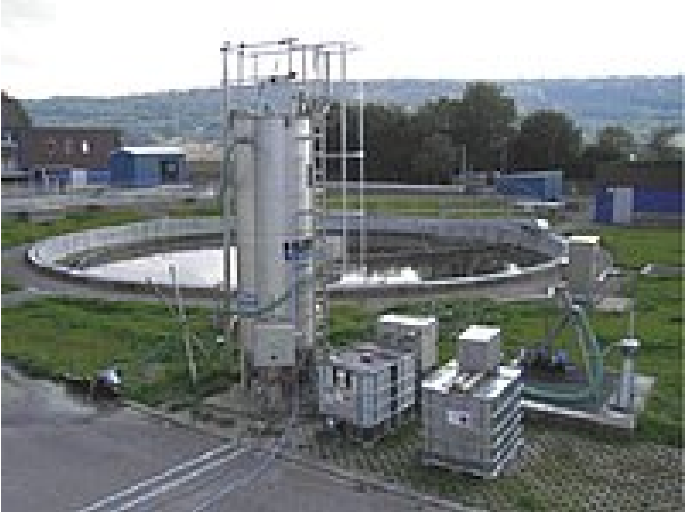
Bild der Versuchsanlage für die nachgeschaltete Denitrifikation im HUBER CONTIFLOW® Sandfilter CF5F
