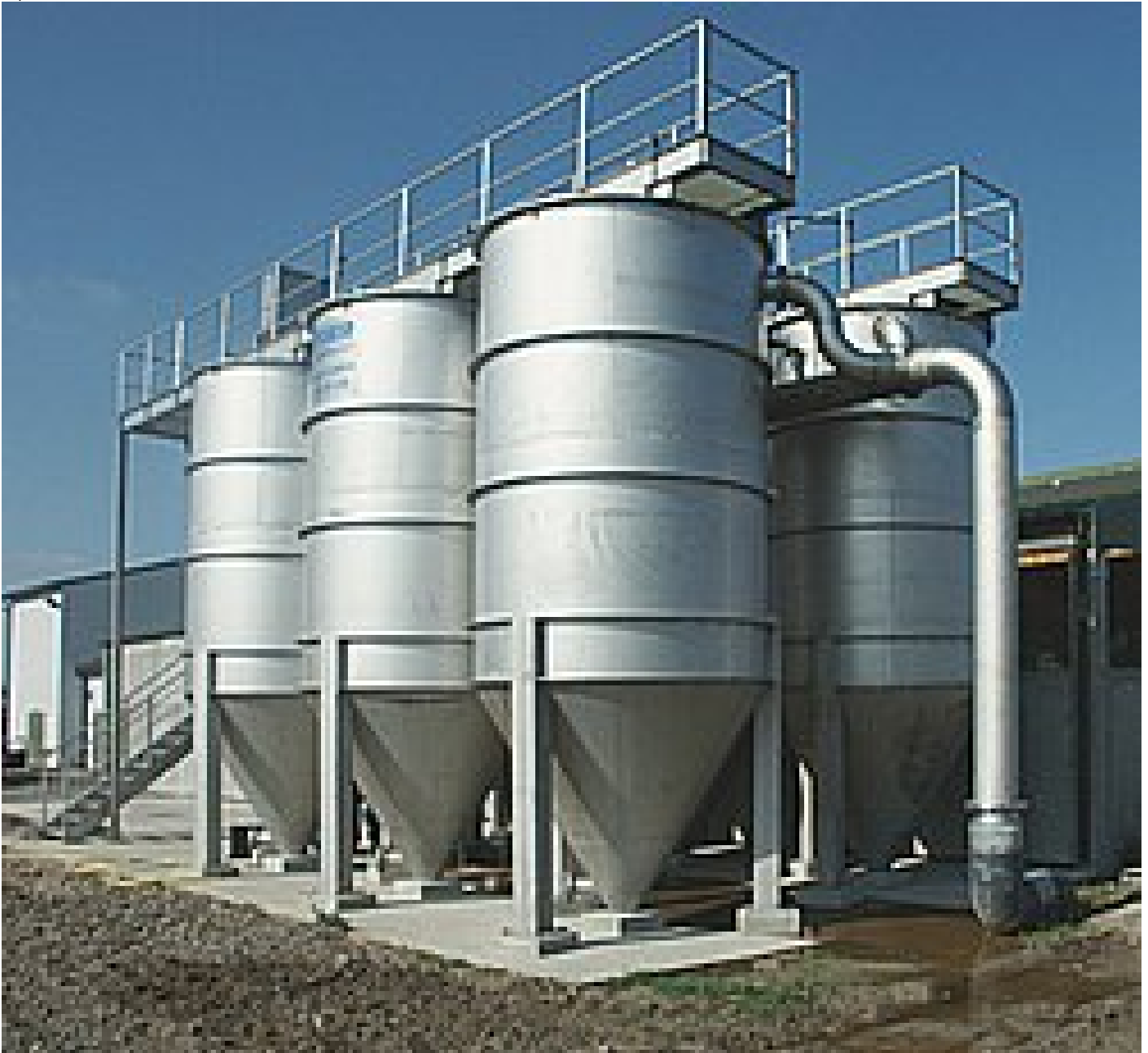
Großtechnische Filtrationsanlage - 6x HUBER Sandfilter Contiflow® CFSF 51
